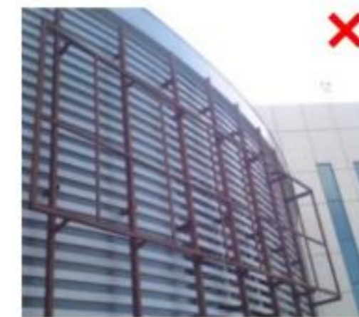
⊘ конструкции, не демонтированные после установки рекламы
