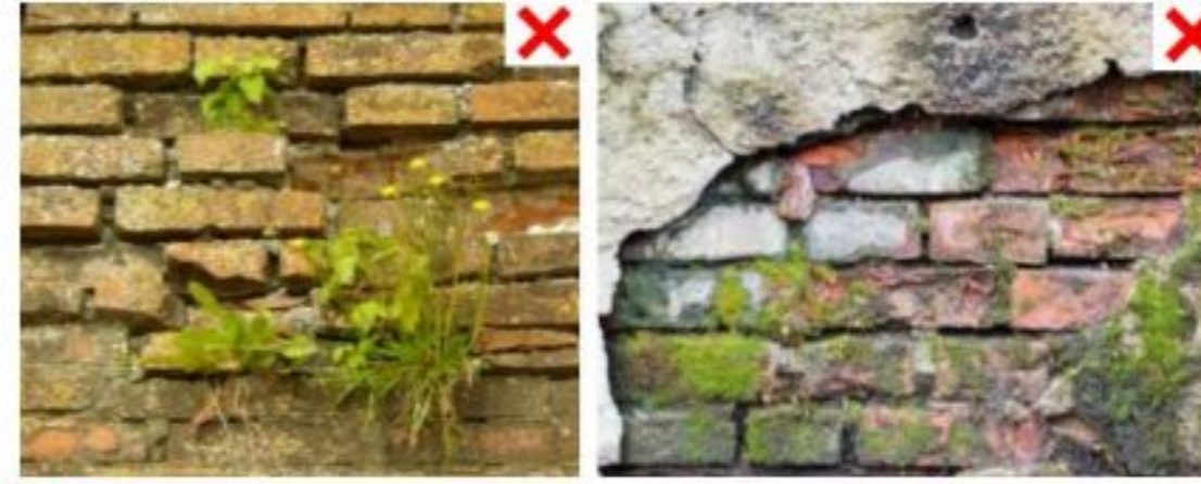
⊘ сорняки, мхи на фасаде
